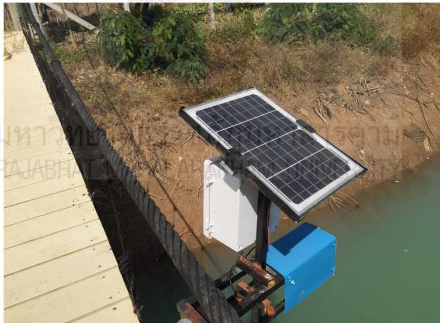
ภาพที่ 4.41 อุปกรณ์ IOT เพื่อรับส่งสัญญาณแต่ละจุดในการอ่านระดับน้ำแต่ละจุด
