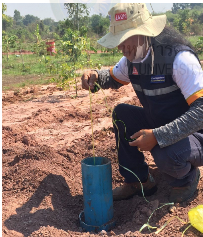
ภาพที่ 4.39 ทำการตรวจสอบนวัตกรรมธนาคารน้ำใต้ดินระบบรางไรท่อ
