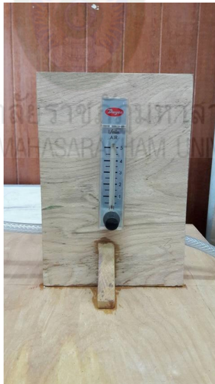
รูปที่ ก. 9 แสดงแสดงการติดตั้งตัวควบคุมอัตราการไหล (flow meter)
