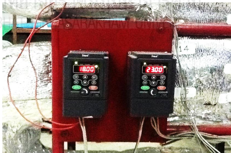
รูปที่ 3.8 แผงควบคุม
