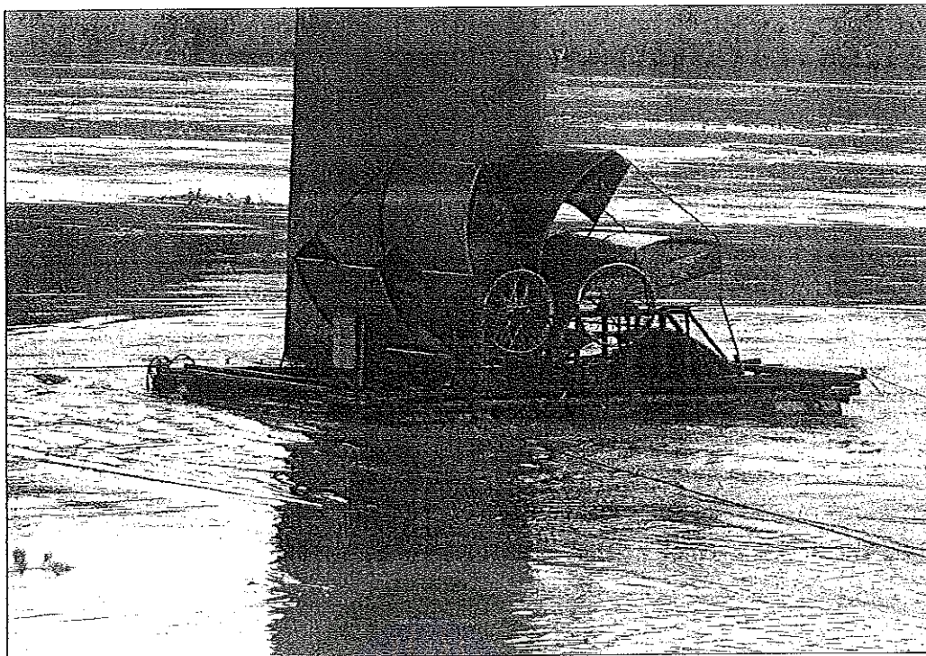
ภาพที่ 32 กังหันน้ำผลิตกระแสไฟฟ้าที่ติดตั้งในแม่น้ำชี บ้านท่าสองคอน ตำบลท่าสองคอน อำเภอเมือง จังหวัดมหาสารคาม
