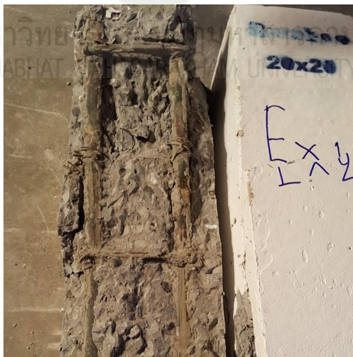
ภาพประกอบที่ 44 การวิบัติของเสาคอนกรีต
