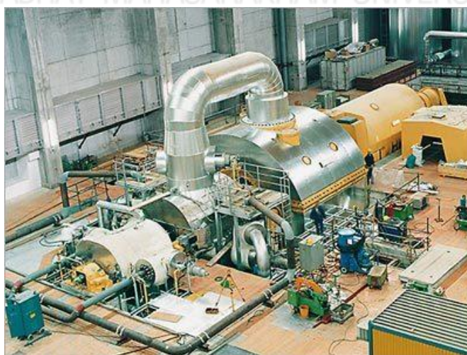
รูปที่ 2.20 กังหันไอน้ำผลิตไฟฟ้า
